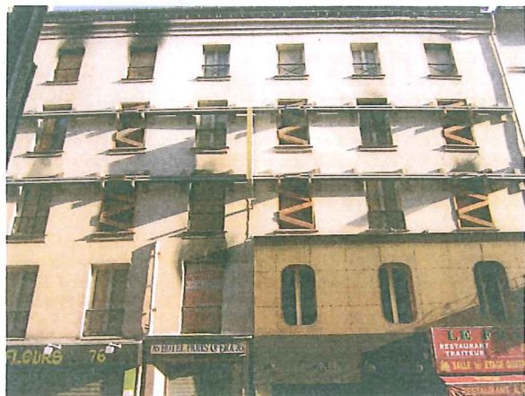
L'incendie meurtrier de l'hôtel de Provence à Paris en 2010 avait poussé le gouvernement de l'époque à exiger une mise aux normes rapide. Elle pourrait être assouplie.
